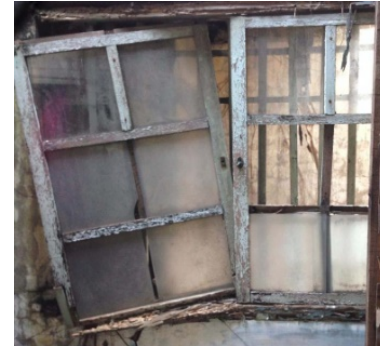
細部損壞現況
