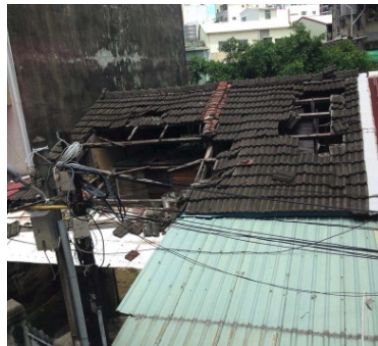
老屋損壞現況
